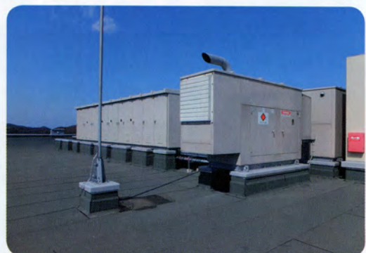
第3(非常用発電機)
