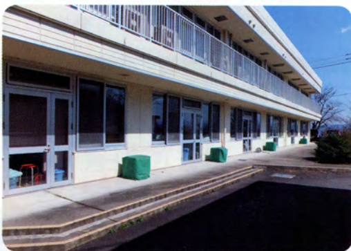
1病棟南ポータブル発電機
