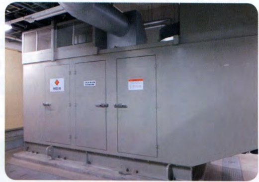
第1(非常用発電機)
