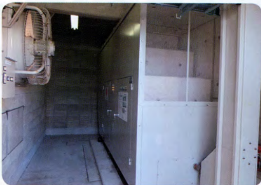
第2(非常用発電機)
